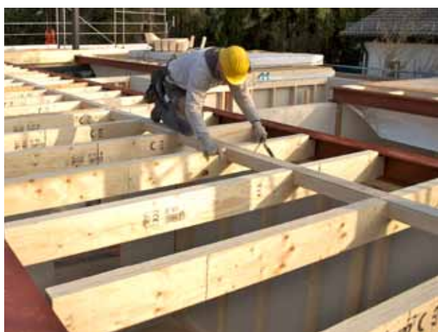
STEICO LVL R jako nosná konstrukce stropu.
