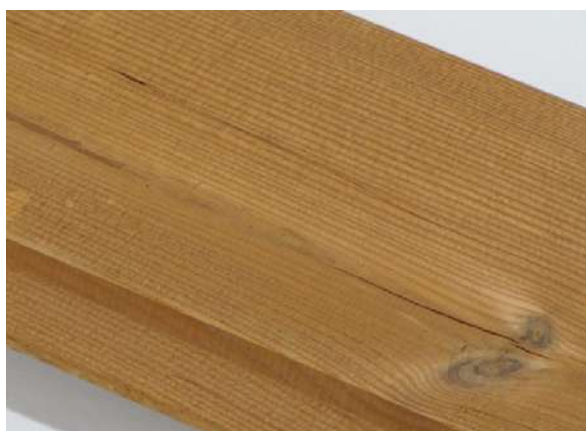
Malé podélné trhliny na povrchu jsou povoleny.
